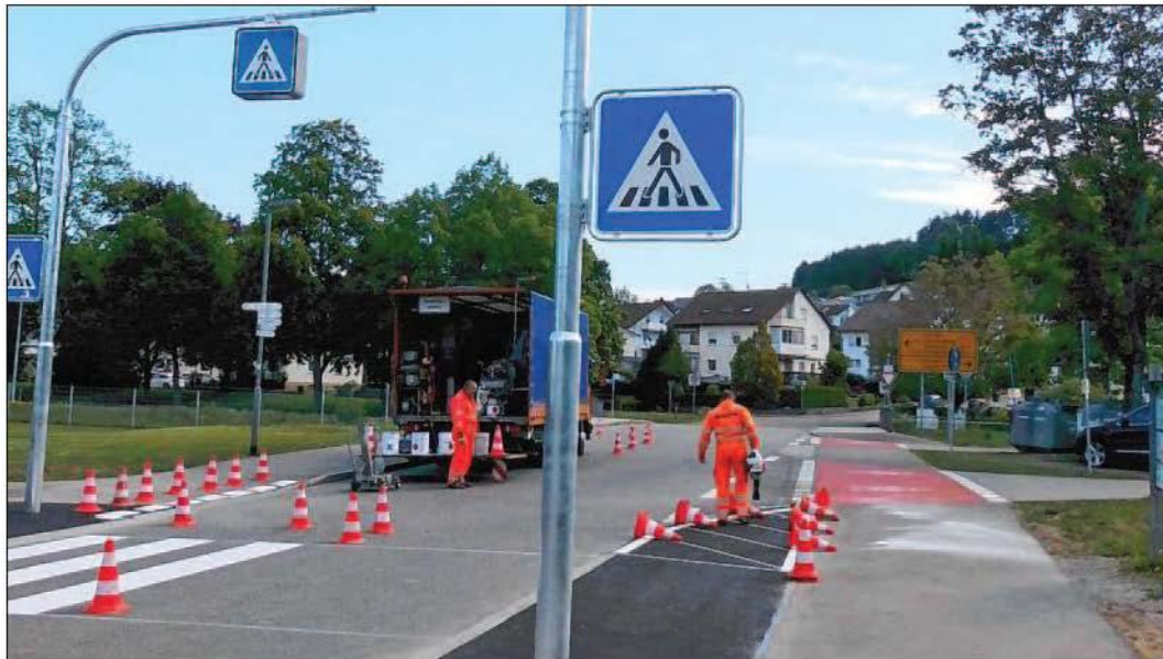
Auf der Manfred-Hildenbrand-Straße wurde zum Waldseeparkplatz hin in den vergangenen Tagen ein Zebrastreifen eingerichtet. Foto: Reinhold Heppner
